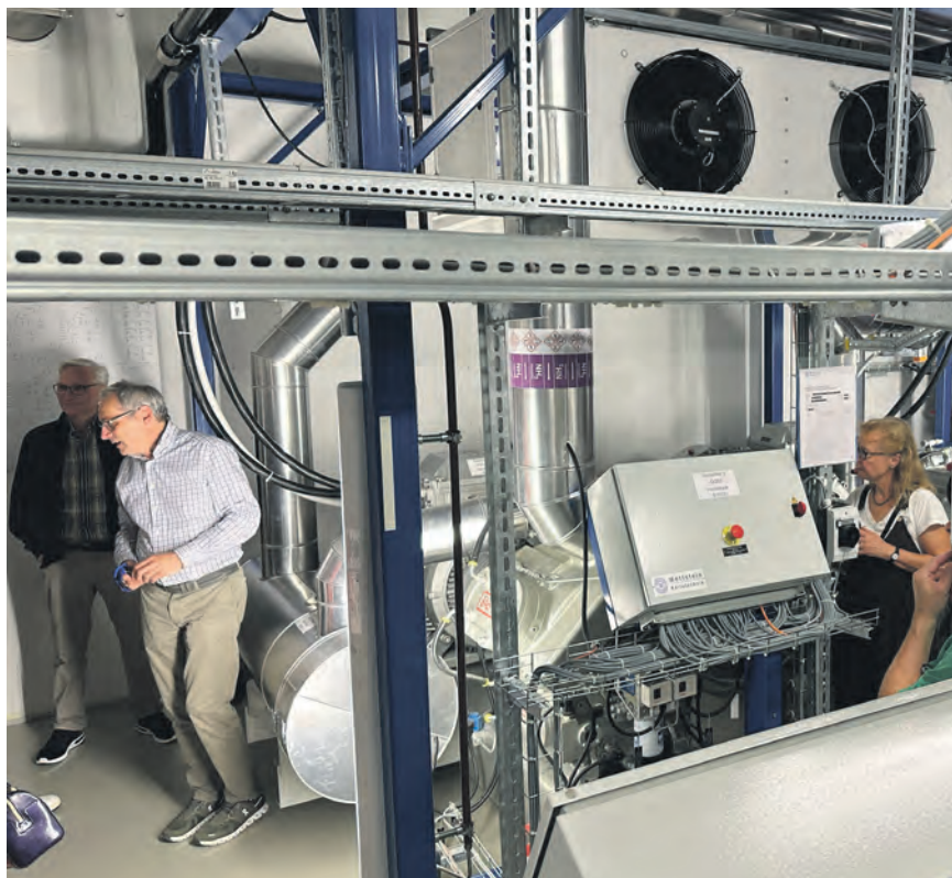
Im zweiten Untergeschoss entsteht Energie für ganz Thalwil.
